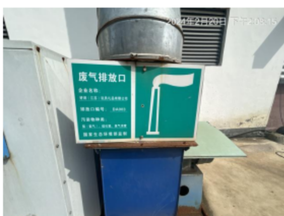
排口标志牌 (DA003)
