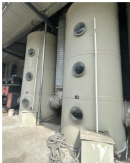
一级水喷淋+一级碱喷淋 (DA001)
