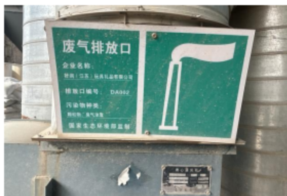
排口标志牌 (DA002)
