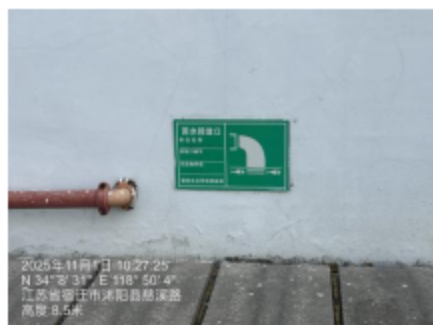
雨水排放口标识牌
