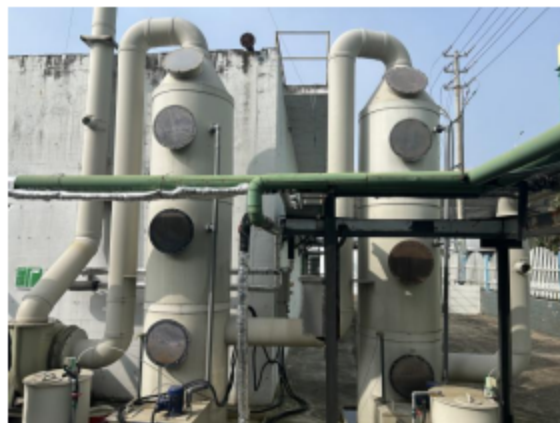
生物除臭装置 (DA003)
